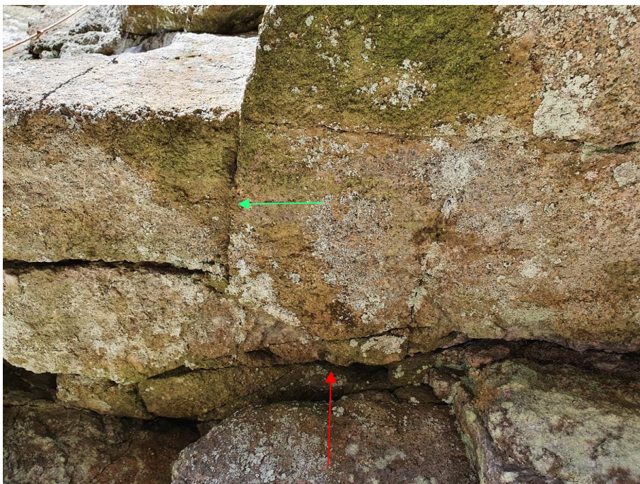
Foto 3. Detaljbild av ett överhäng med avskärande sprickor i bakkant (röd pil) och tvärs slänten (grön pil).
