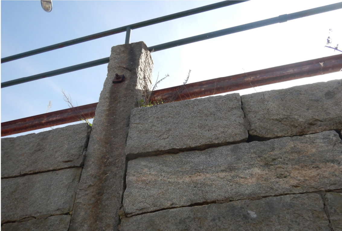
Figur 15: Skadebild, skada nr. 10
