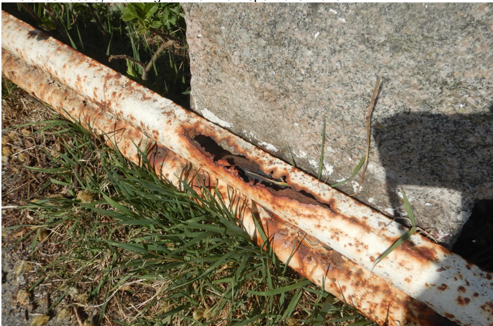
Figur 6: Skadebild, skada nr. 1
