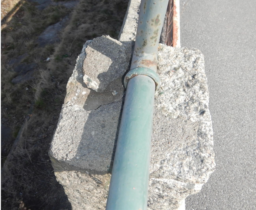
Figur 11: Skadebild, skada nr.6
