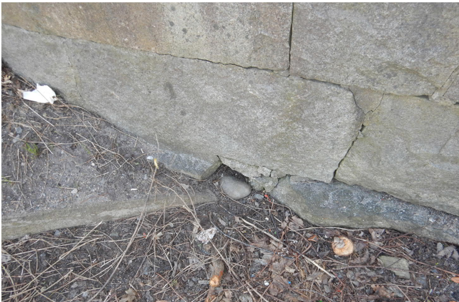
Figur 14: Skadebild, skada nr. 9
