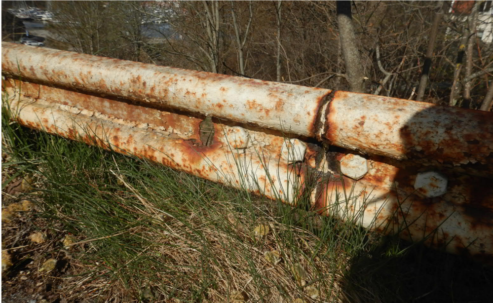
Figur 7: Skadebild, skada nr.2
