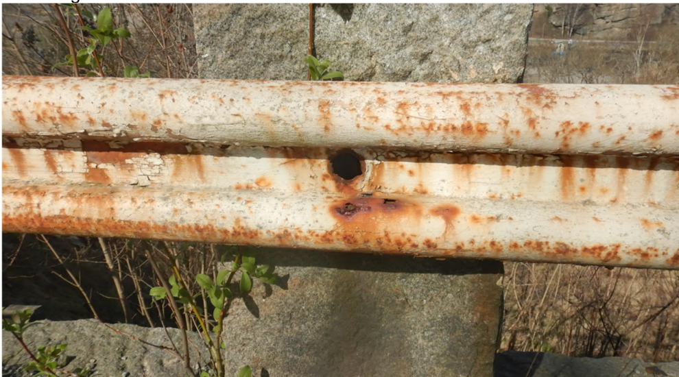
Figur 8: Skadebild, skada nr.3
