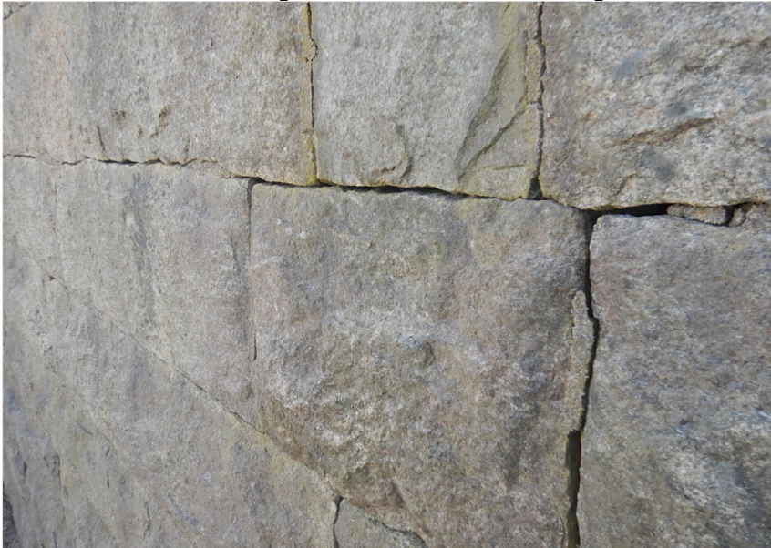
Figur 12: Skadebild, skada nr. 7
