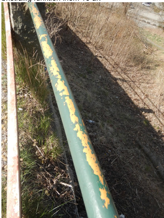
Figur 10: Skadebild, skada nr. 5
