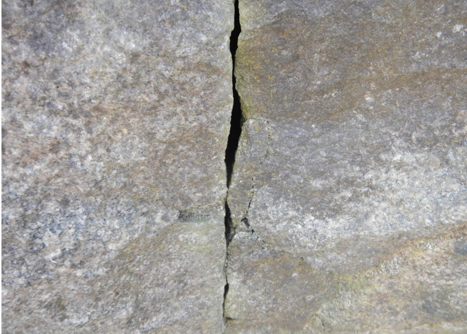
Figur 13: Skadebild, skada nr. 8
