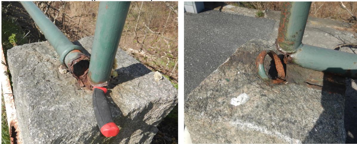
Figur 9: Skadebild, skada nr. 4
