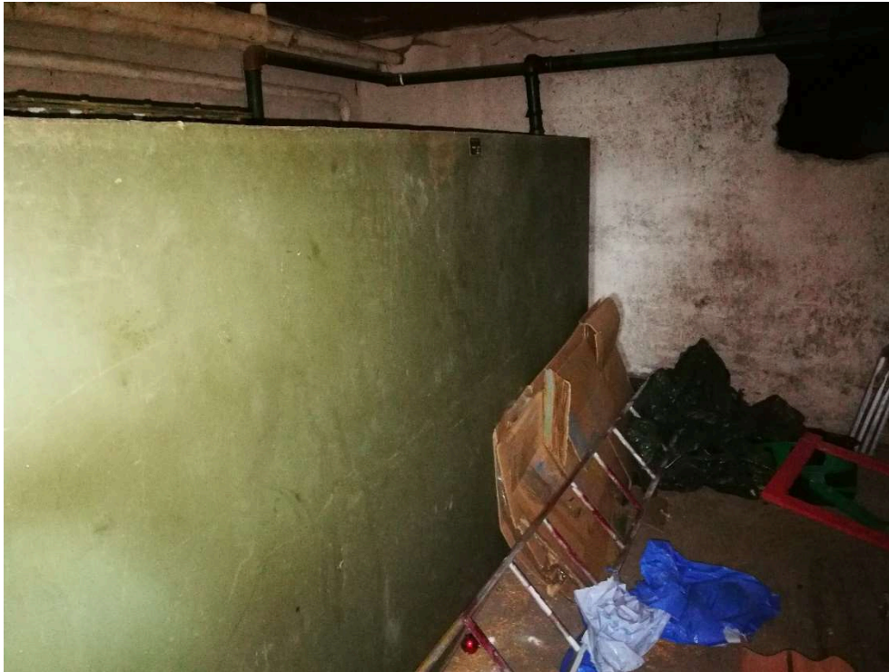
Foto 1. Visar rektangulär eldningsoljetank i pannrum för aktuell huskropp. Eventuell nivå för eldningsolja är ej kontrollerat.
